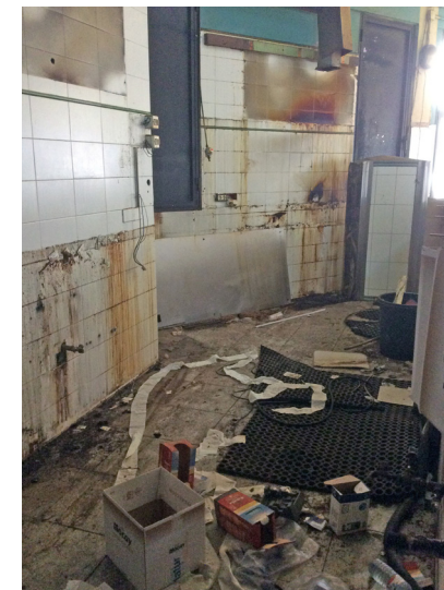
Figura 23. Estado de la cafetería de la estación hoy
