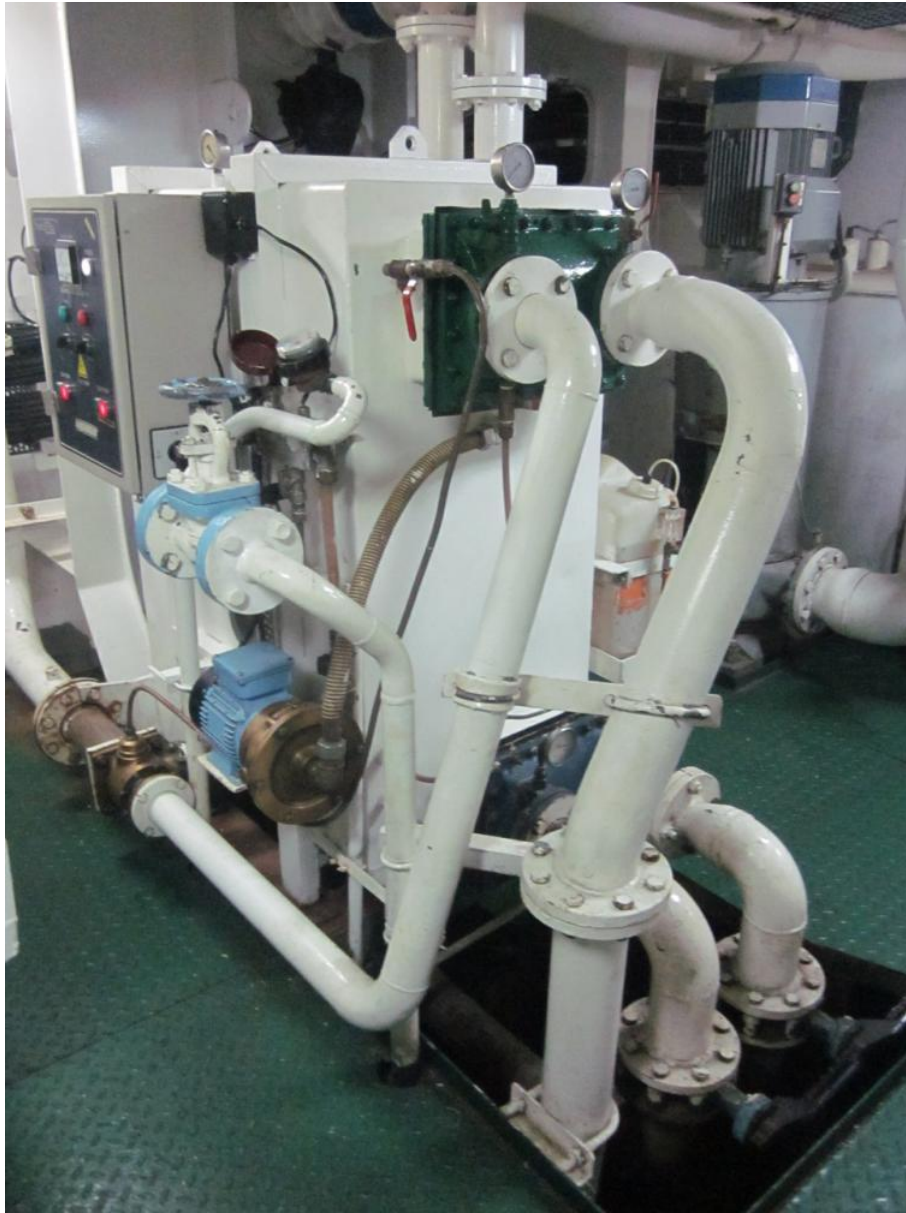
Ilustración 22 - Generador agua destilada AQUAMAR AQ-16/20A. Fuente: Trabajo de campo.
