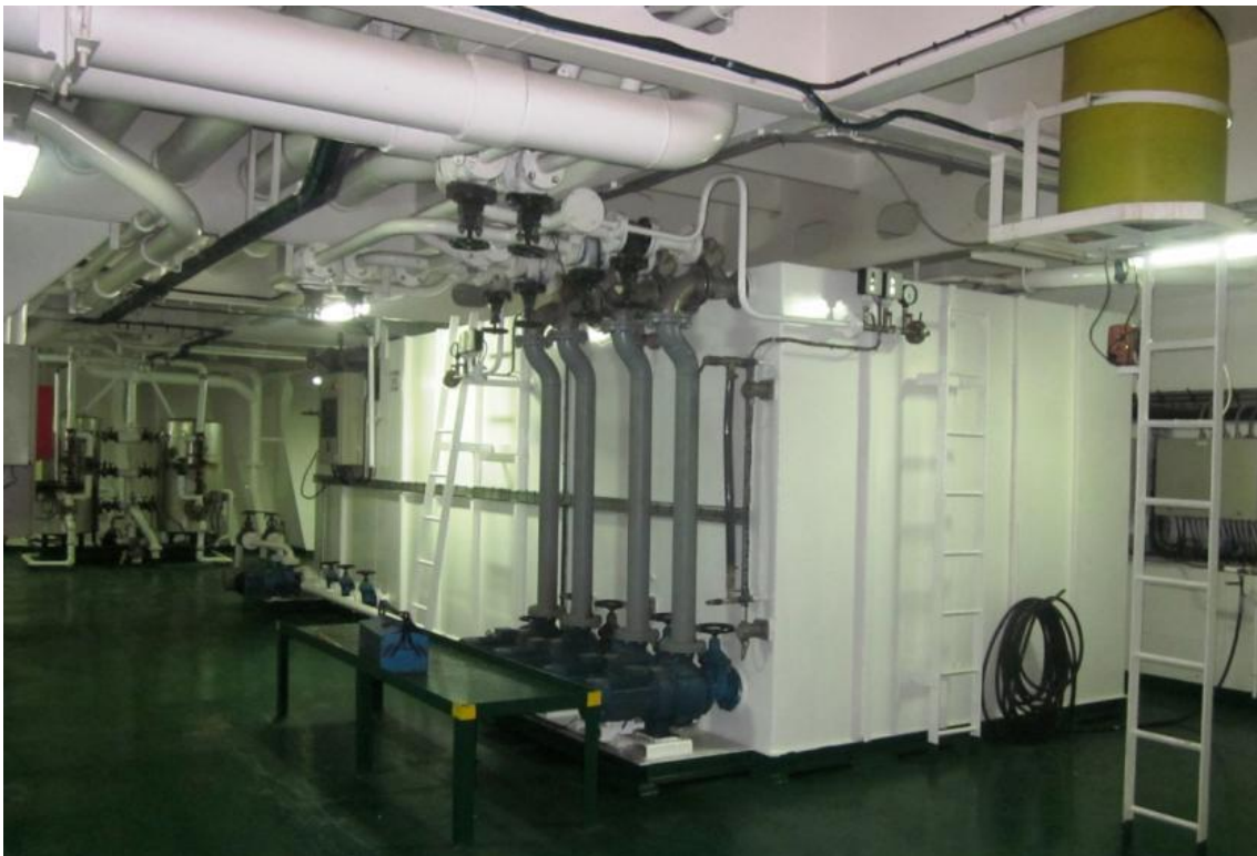
Ilustración 21 - Tratamiento Aguas Fecales y calentadores agua sanitaria. Fuente: Trabajo de campo.
