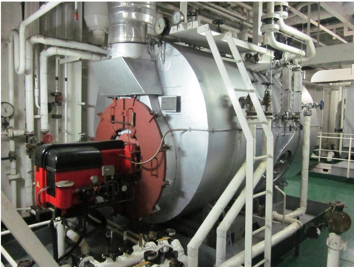
Ilustración 6 - Caldera pirotubular horizontal. Fuente: Trabajo de campo.
