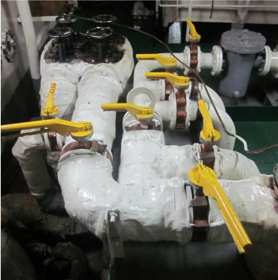
Ilustración 13 - Bloque de válvulas tanques de almacén de HFO. Líneas procedentes de almacén y servicio diario HFO y MDO, sedimentación HFO hacia ambas bombas de trasiego Fuente: Trabajo de campo.
