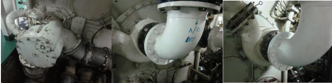
Ilustración 28 - Bombas acopladas de aceite, agua BT y agua AT. Fuente: Trabajo de campo.
