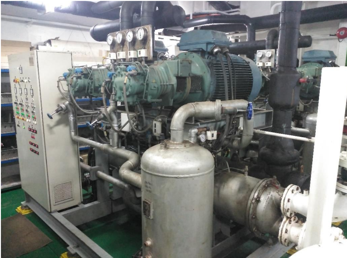
Ilustración 20 - Equipo de aire acondicionado. Fuente: Trabajo de campo.
