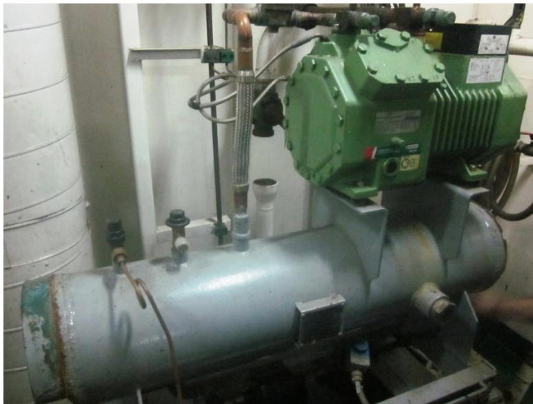
Ilustración 53 - Grupo aire acondicionado del control de máquina
