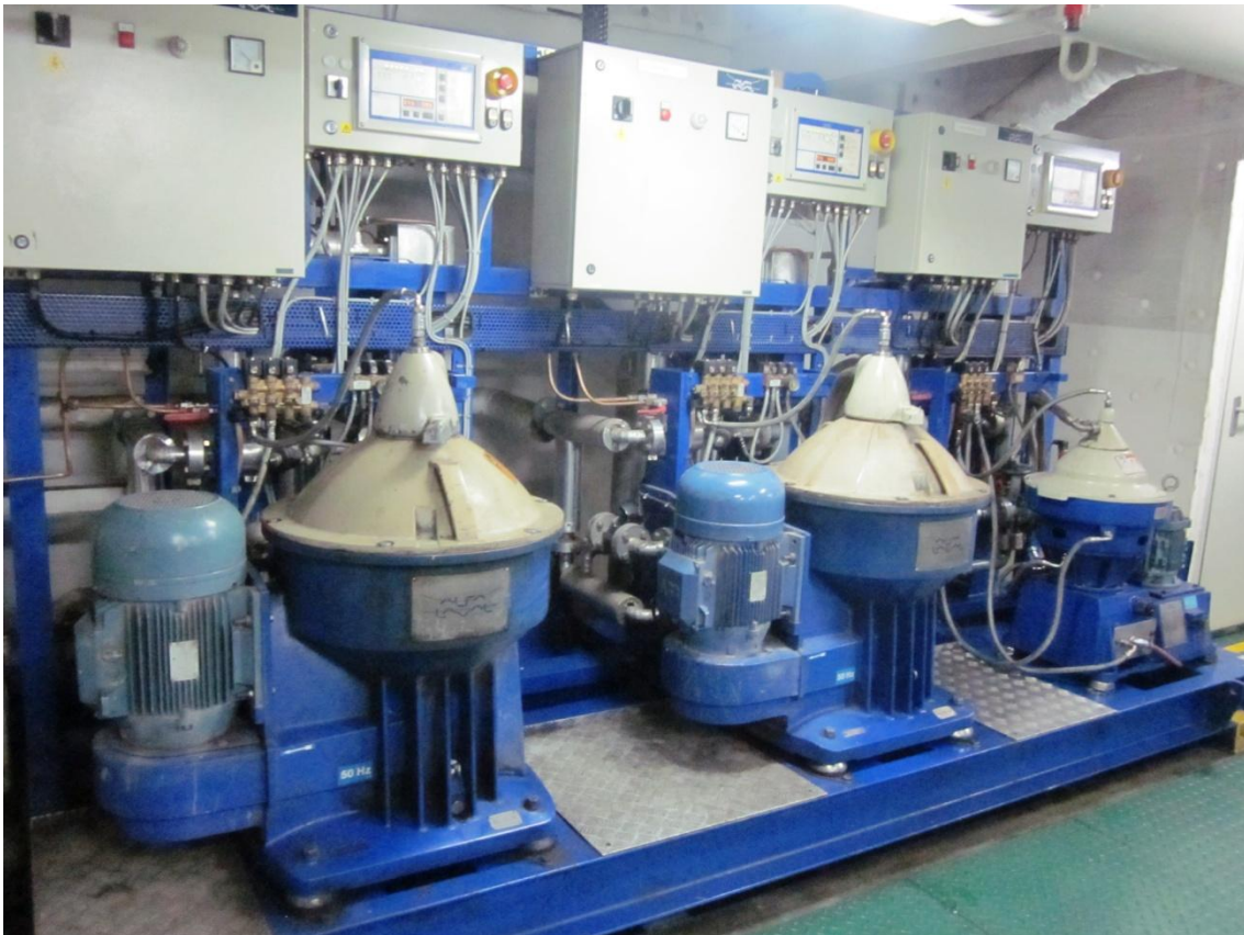
Ilustración 15 - Módulo de depuración de aceite. Fuente: Trabajo de campo.
