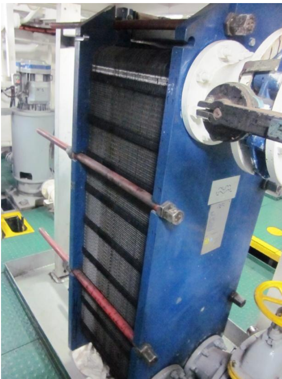
Ilustración 16 – Enfriador de aceite
