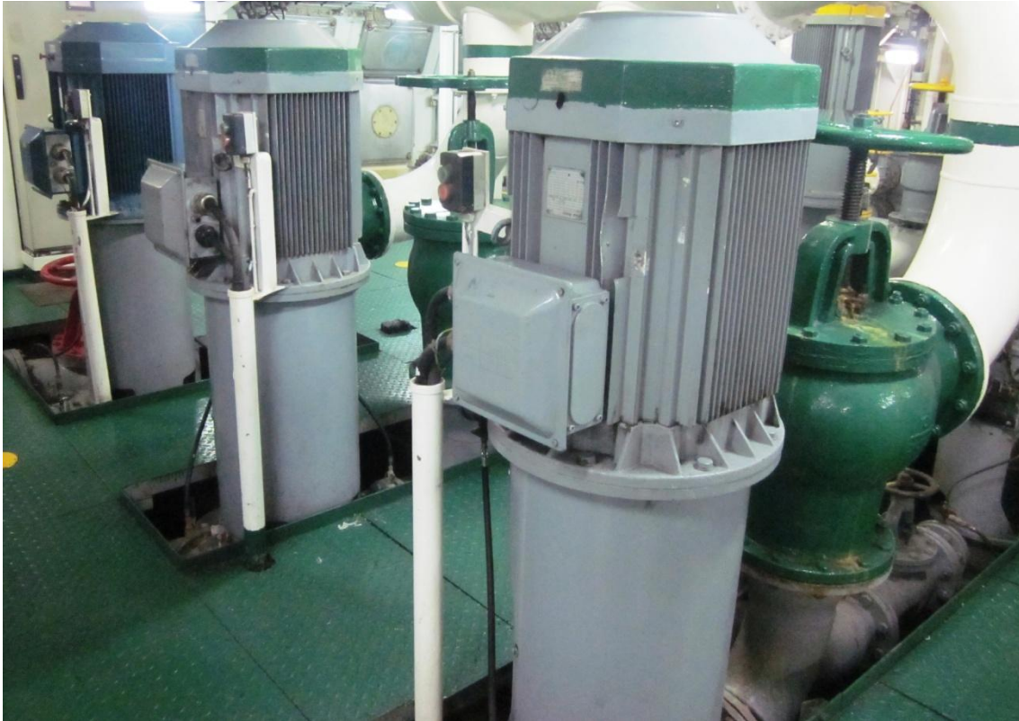
Ilustración 12 - Bombas agua salada del servicio de refrigeración central. Fuente: Trabajo de campo.
