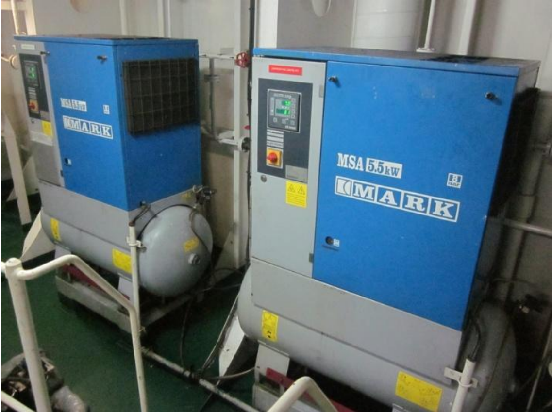
Ilustración 10 - Compresores de aire de 7 bar con botella incorporada. Fuente: Trabajo de campo.
