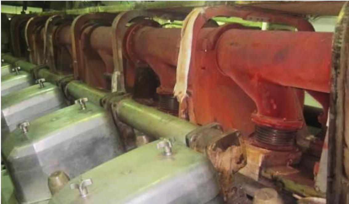
Ilustración 33 - Colector de gases de escape. Fuente: Trabajo de campo.
