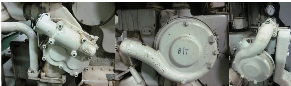
Ilustración 40 - Bombas acopladas de aceite, agua de BT y agua de AT. Fuente: Trabajo de campo.
