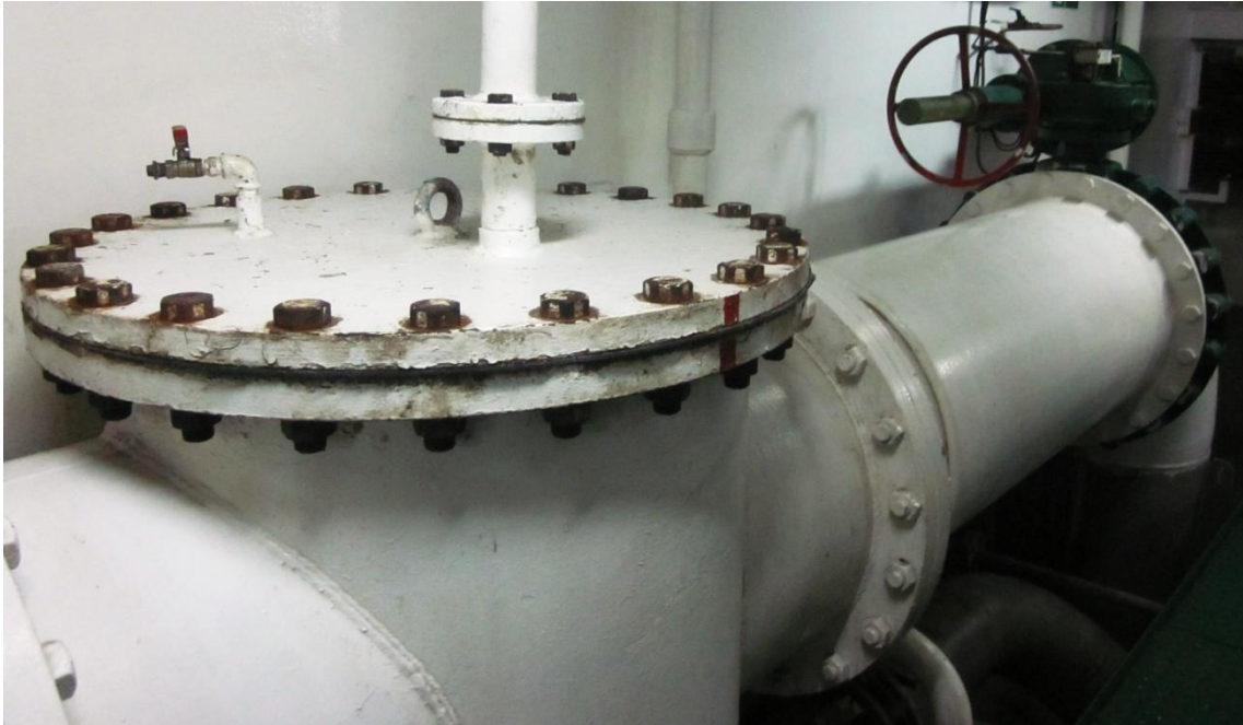
Ilustración 11 - Filtro de fondo y válvula motorizada de aspiración de la toma de mar. Fuente: Trabajo de campo.
