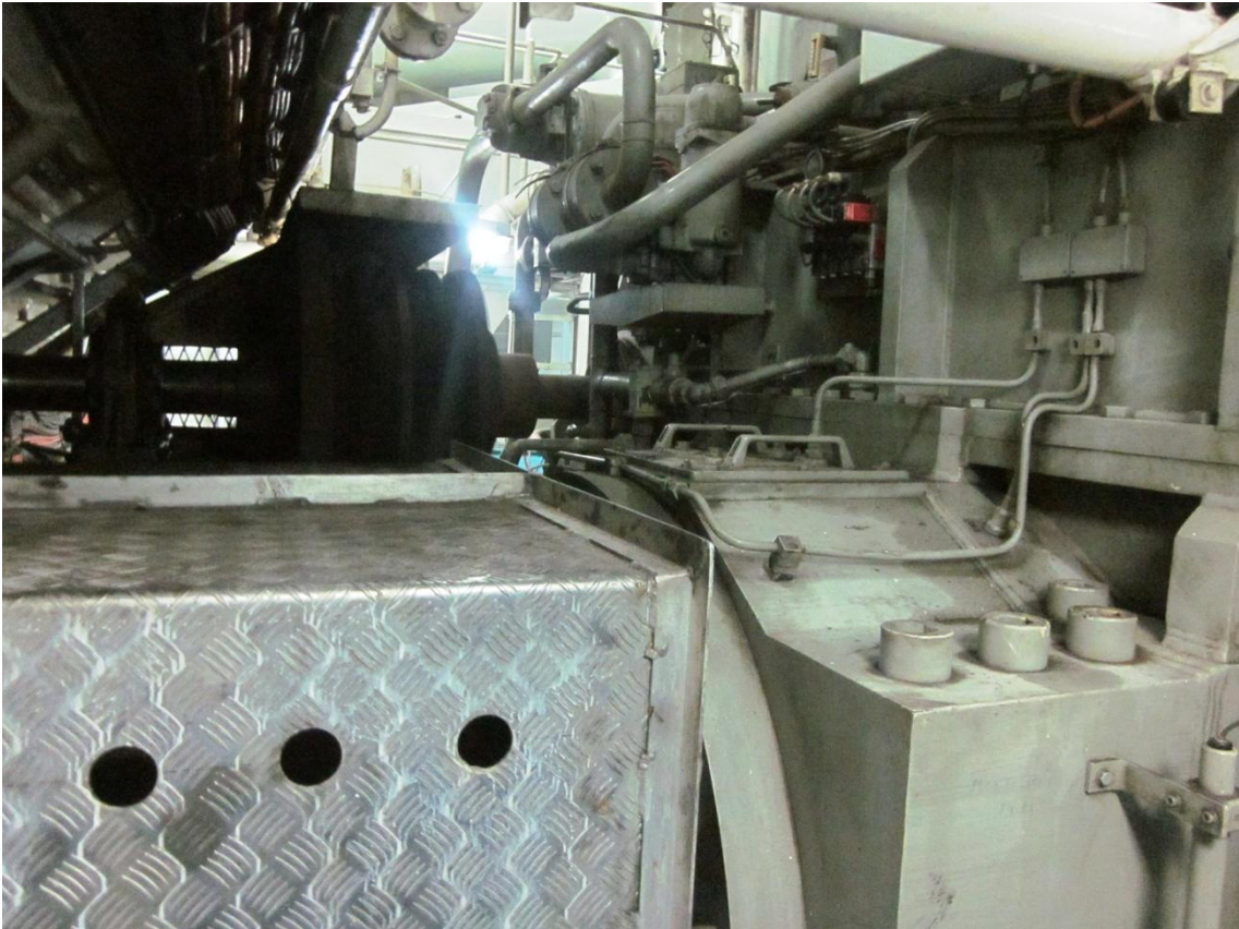
Ilustración 34 - Reductora MP babor. Fuente: Trabajo de campo.
