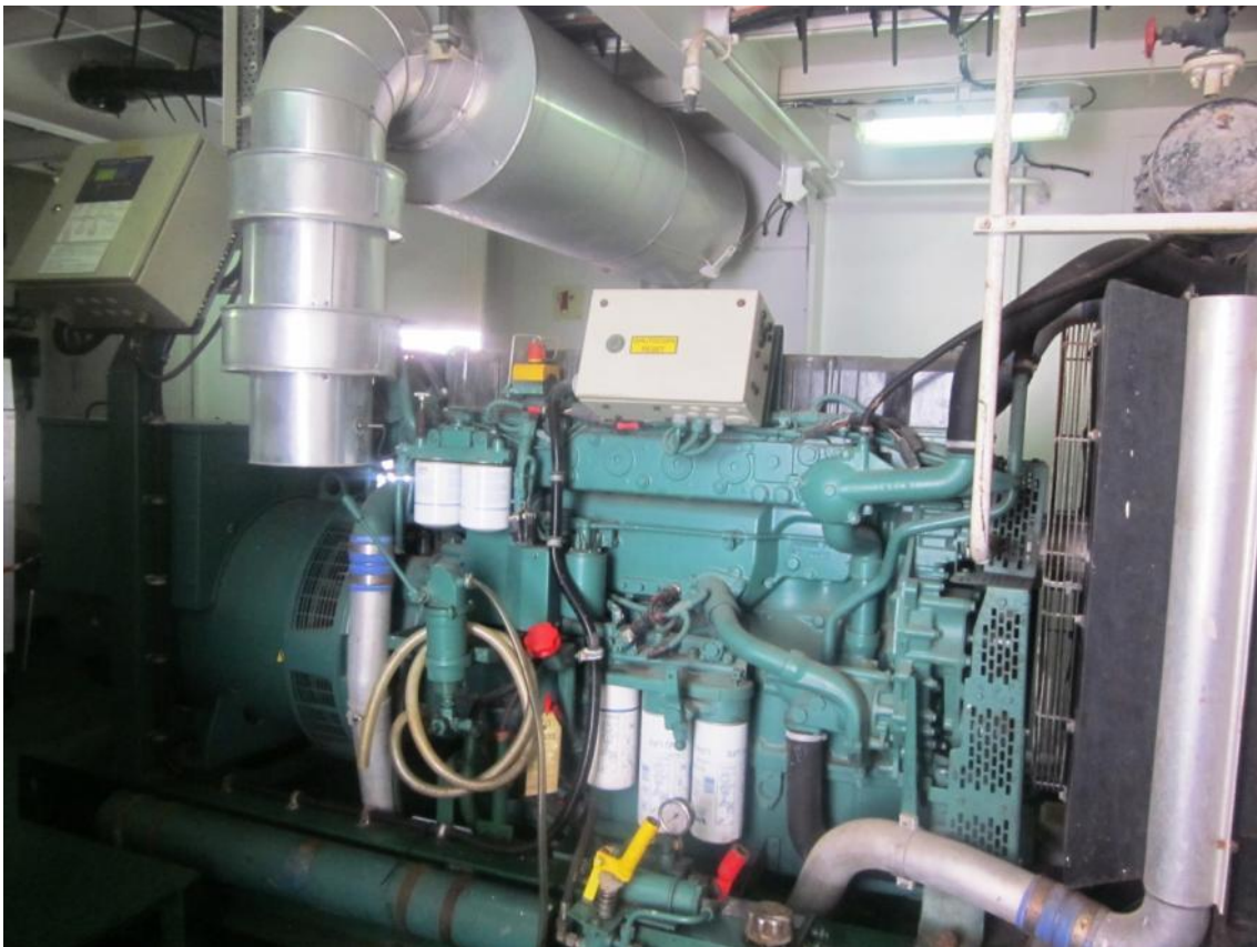
Ilustración 4- Motor de emergencia. Fuente: Trabajo de campo.
