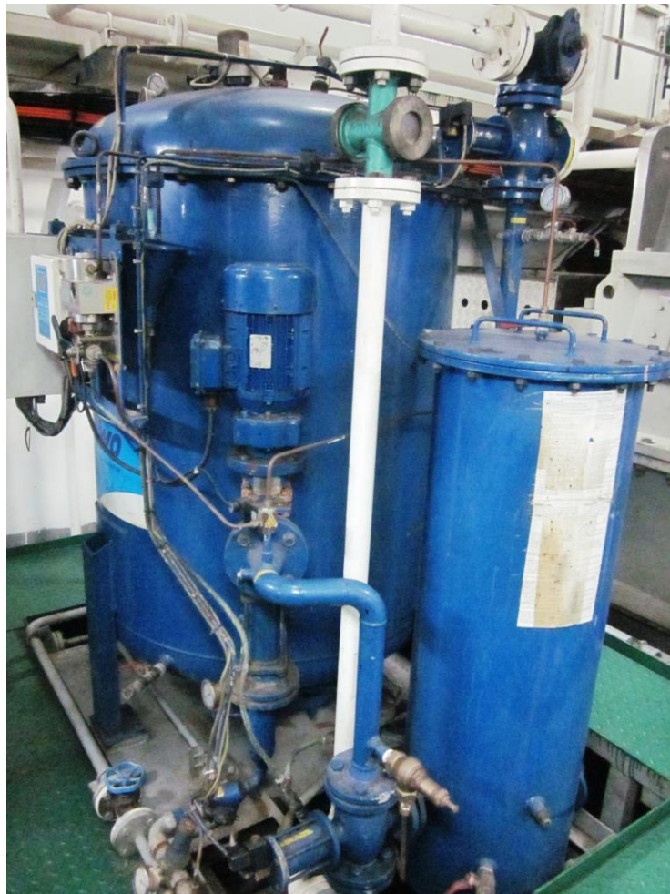
Ilustración 23 - Separador de aguas aceitosas. Fuente: Trabajo de campo.
