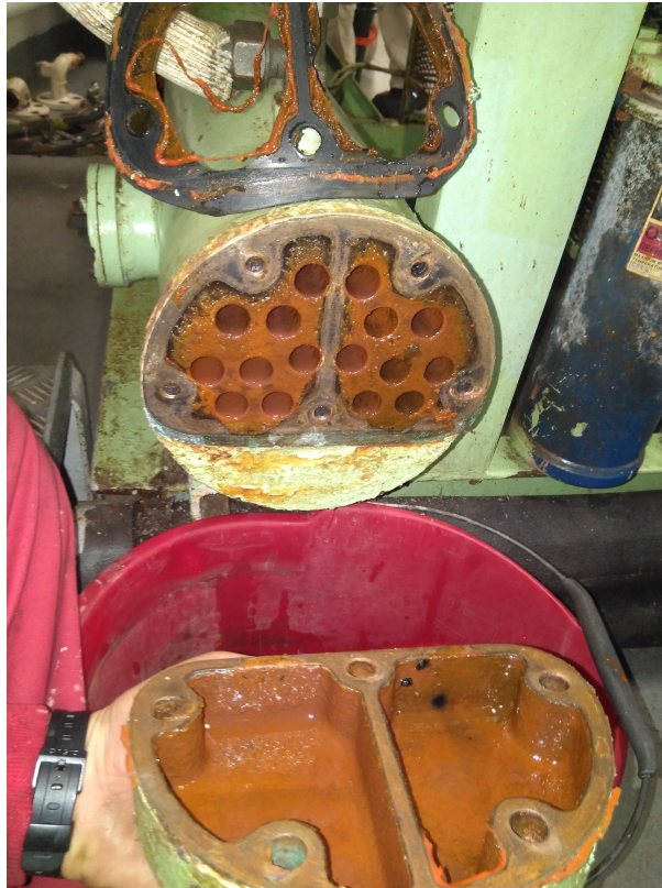
Figura 5.1: Estado del condensador previo a su limpieza Fuente: Fotografía de colección propia en la instalación
