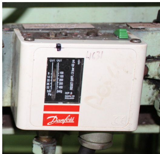
Figura 4.11: Presostato KP Fuente: Fotografía de colección propia en la instalación
