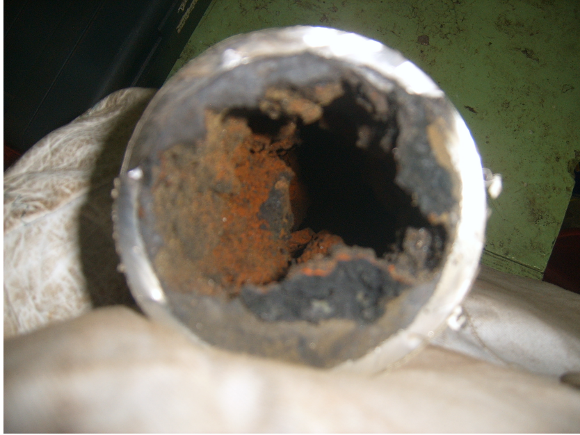
Figura 10.1: Sección de la tubería de agua a la salida del condensador Fuente: Fotografía de colección propia en la instalación
