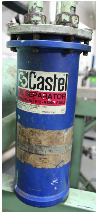
Figura 4.10: Filtro separador de aceite Fuente: Fotografía de colección propia en la instalación
