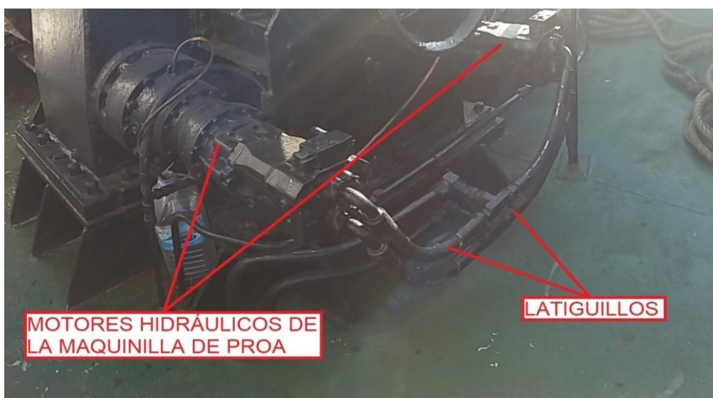
Ilustración n° 26 Motores hidráulicos del chigre o maquinilla de proa. Fuente: Elaboración propia.
