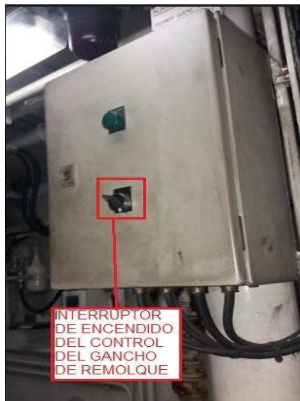
Ilustración n° 56 Armario eléctrico con los controles del gancho y su botón de encendido de la bomba. Fuente: Elaboración propia.
