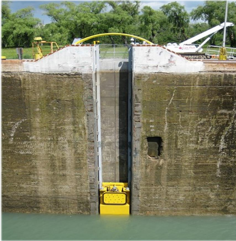
(3) Sistema instalado en un canal de paso interior (Modelo 200 LS).
