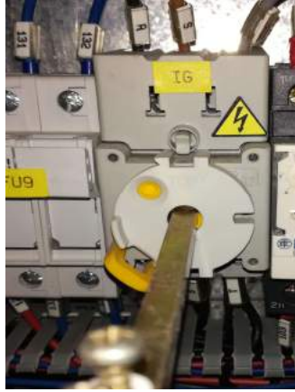
Figura 14: Interruptor general de alimentación
