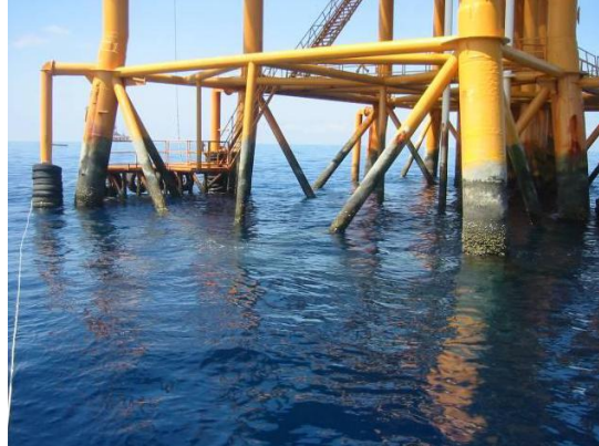
Fig. nº 9. Estructura tipo Jacket en alta mar
