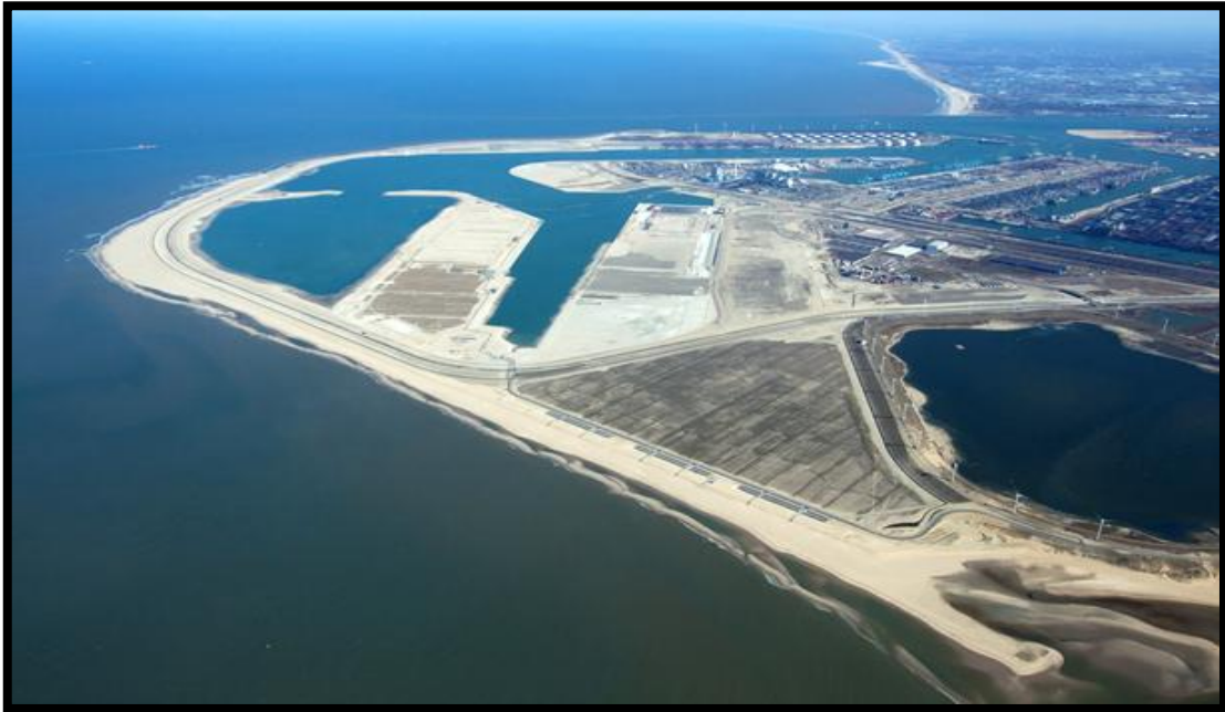
Ilustración 25: Trabajos de construcción en el nuevo área de Maasvlakte 2. (Fuente: Maritime Journal, en línea)
