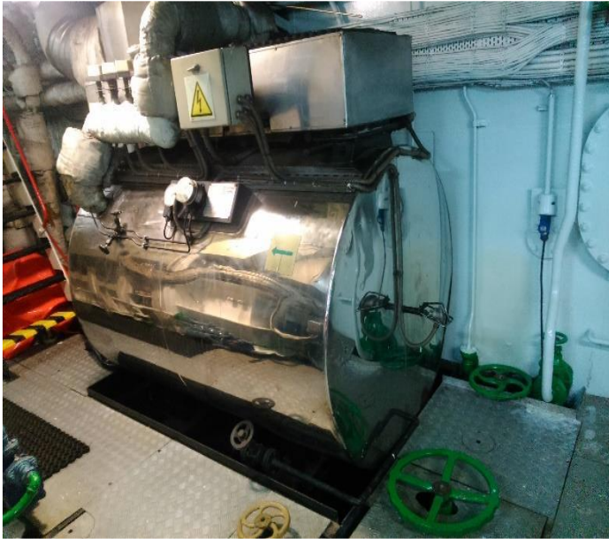
Ilustración 19: Caldera Imagen Trabajo de Campo
