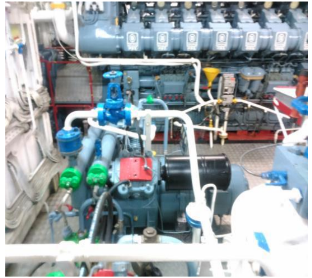
Ilustración 17: Compresor N°1 Trabajo de Campo
