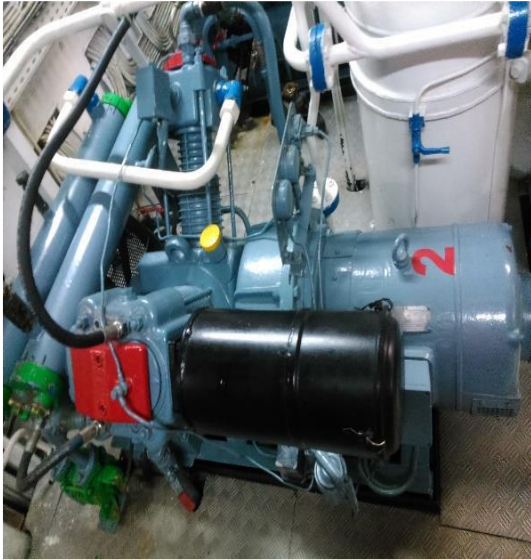
Ilustración 16: Compresor N°2 Trabajo de Campo
