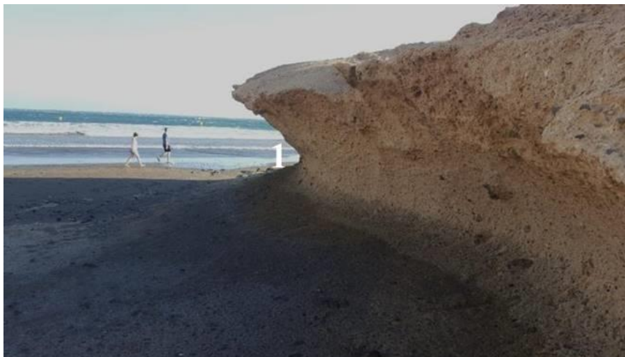
Figura 5. Acantilado con socavamiento basal (El Médano, SE de Tenerife) (Autor: Rodríguez, O., 2018).
