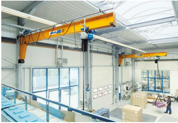
Ilustración 12. Grúa en ménsula. https://goo.gl/n9KGTe
