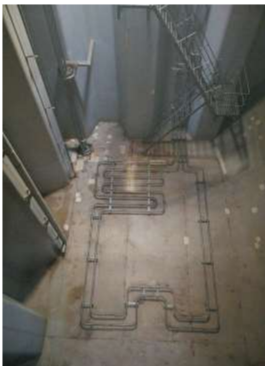
Ilustración 12. Líneas de Calefacción Tanques de Carga. Fuente: Trabajo de Campo
