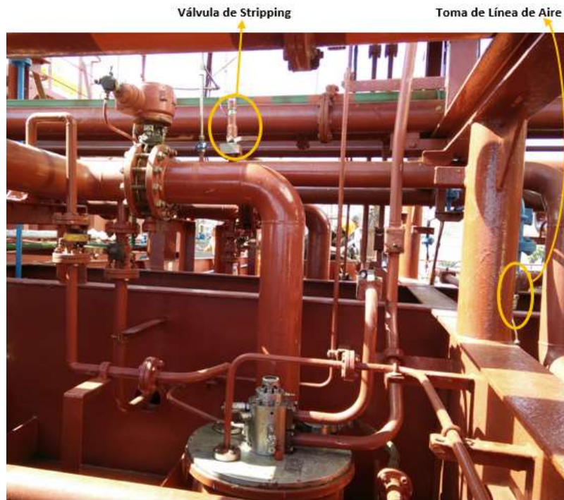
Ilustración 63. Toma de Aire y Válvula de Stripping. Fuente: Trabajo de Campo
