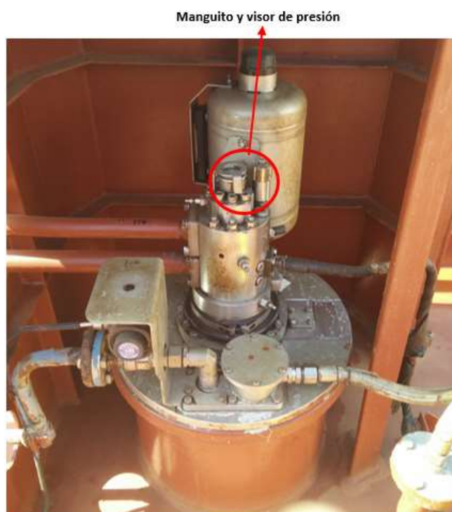
Ilustración 51. Vista Bomba Lastre desde Cubierta Ppal. Fuente: Trabajo de Campo
