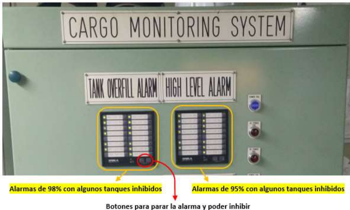
Ilustración 29. Panel Alarmas de los Tanques de Carga. Fuente: Trabajo de Campo
