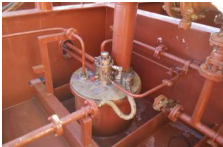
Ilustración 19. Vista desde Cubierta Bomba de Descarga. Fuente: Trabajo de Campo
