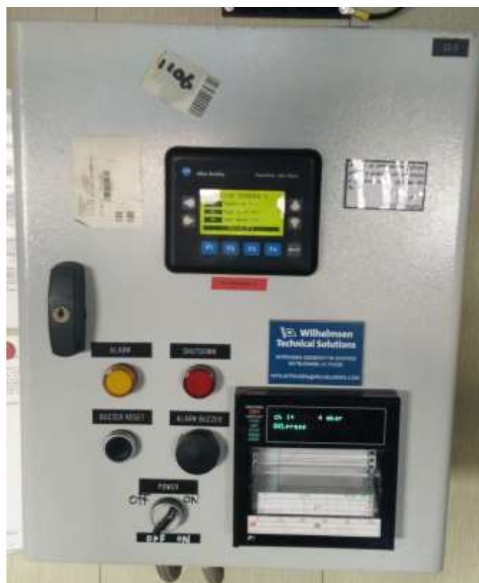
Ilustración 41. Sistema Controlador Planta de Nitrógeno. Fuente: Trabajo de Campo
