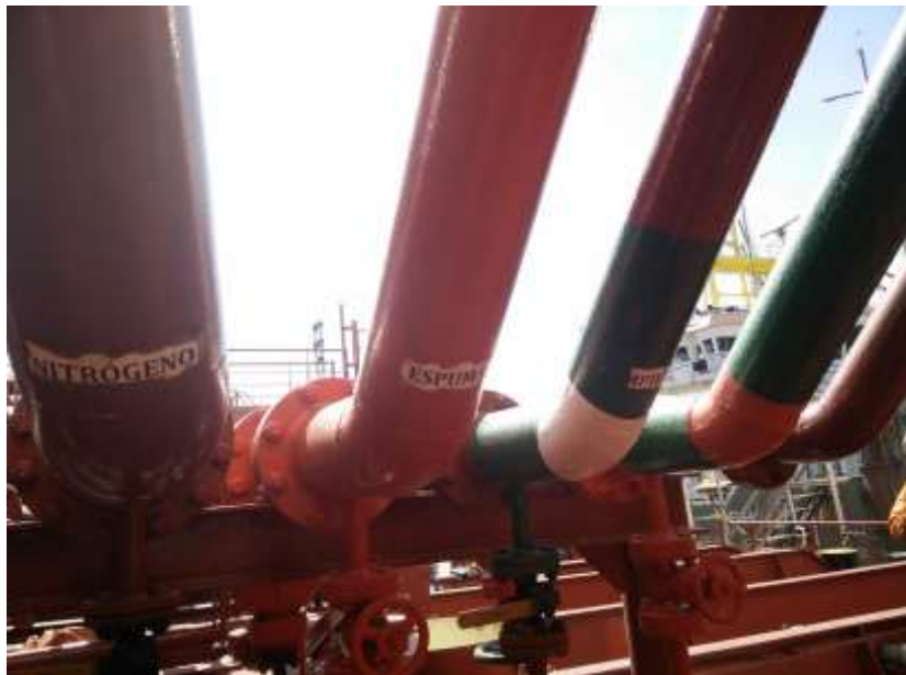
Ilustración 44. Líneas de Nitrógeno, Espuma, Limpieza, ... Fuente: Trabajo de Campo
