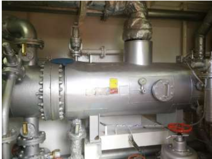
Ilustración 62. Calentador Agua Limpieza. Fuente: Trabajo de Campo
