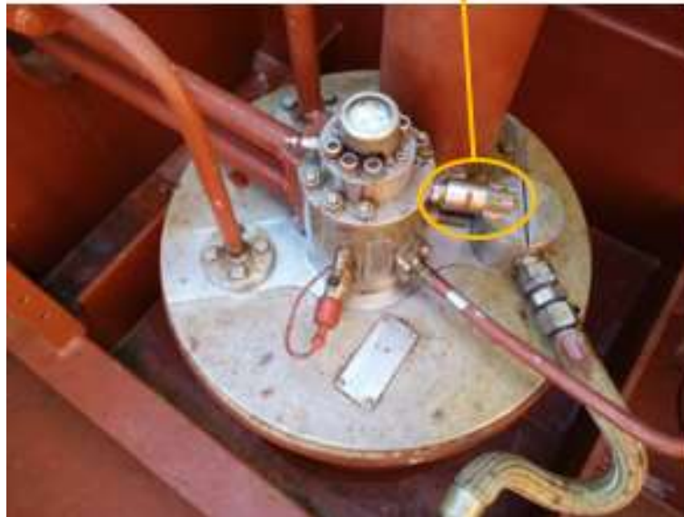
Ilustración 20. Manguito Bomba de Descarga. Fuente: Trabajo de Campo
