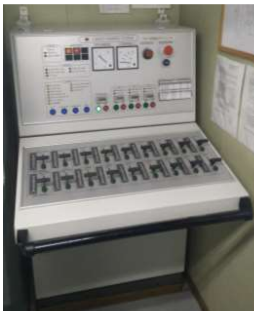
Ilustración 34. Unidad Controladora Remota FRAMO. Fuente: Trabajo de Campo
