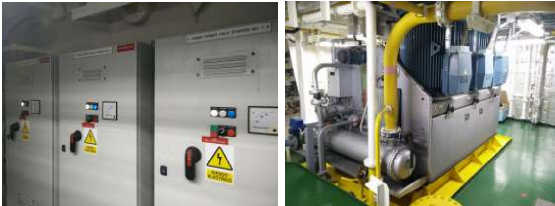
Ilustración 15. Power Packs y Jockey Pump en el Local del FRAMO. Fuente: Trabajo de Campo
