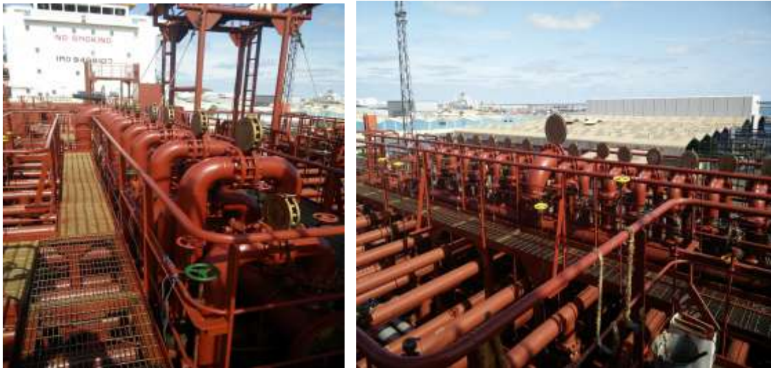
Ilustración 5. Colectores Br y Er B/Q Tinerfe. Fuente: Trabajo de Campo
