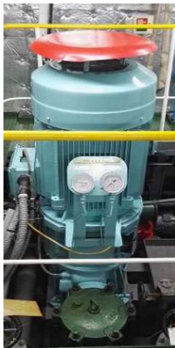
Ilustración 53. Bomba Servicios Generales y Contra incendios. Fuente: Trabajo de Campo
