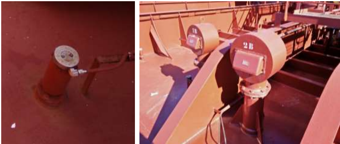
Ilustración 50. Gas Sampling y Suspiros de Tanques de Lastre. Fuente: Trabajo de Campo
