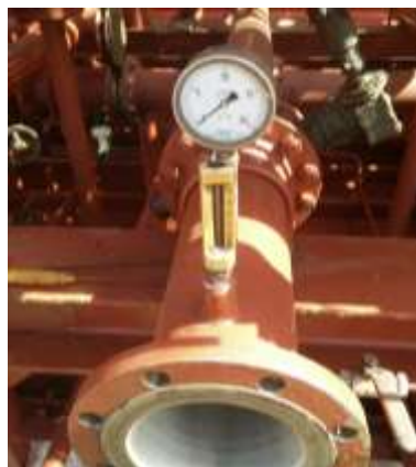
Ilustración 65. Manómetro de los Manifolds. Fuente: Trabajo de Campo
