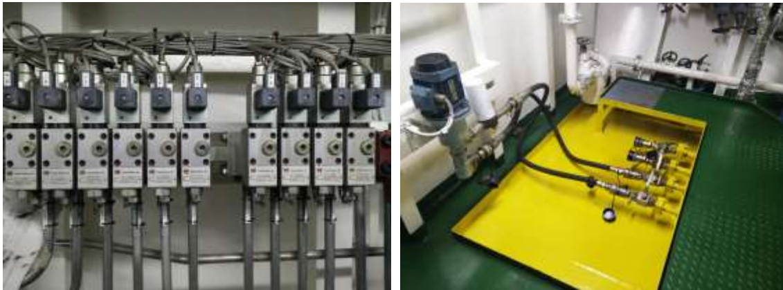
Ilustración 17. Pilotadas y Líneas de Aceite Hidráulico FRAMO. Fuente: Trabajo de Campo
