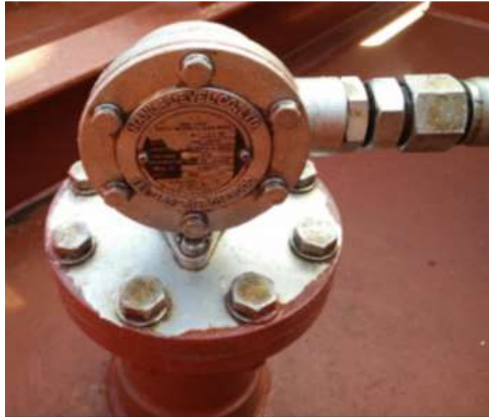
Ilustración 28. Alarmas HI y HI-HI de Tanques de Carga. Fuente: Trabajo de Campo
