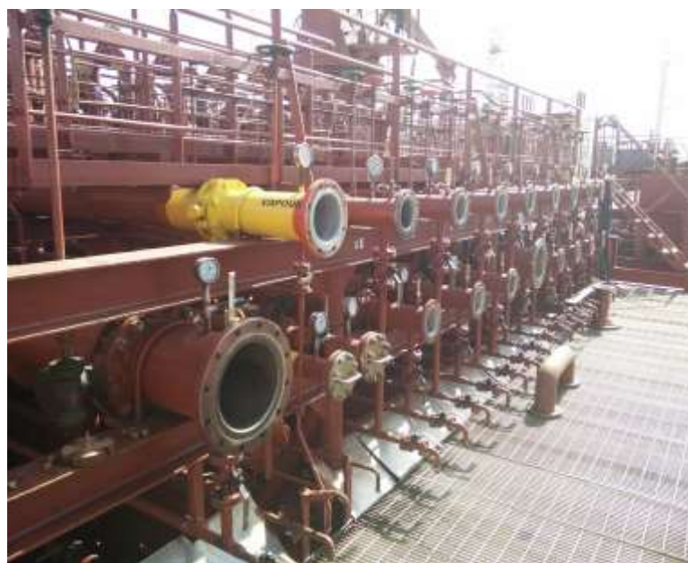
Ilustración 6. Manifolds Er. Fuente: Trabajo de Campo
