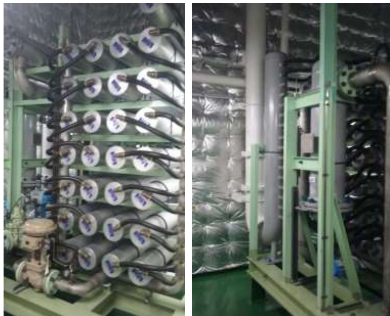
Ilustración 46. Planta Gas Inerte B/Q Tinerfe. Fuente: Trabajo de Campo
