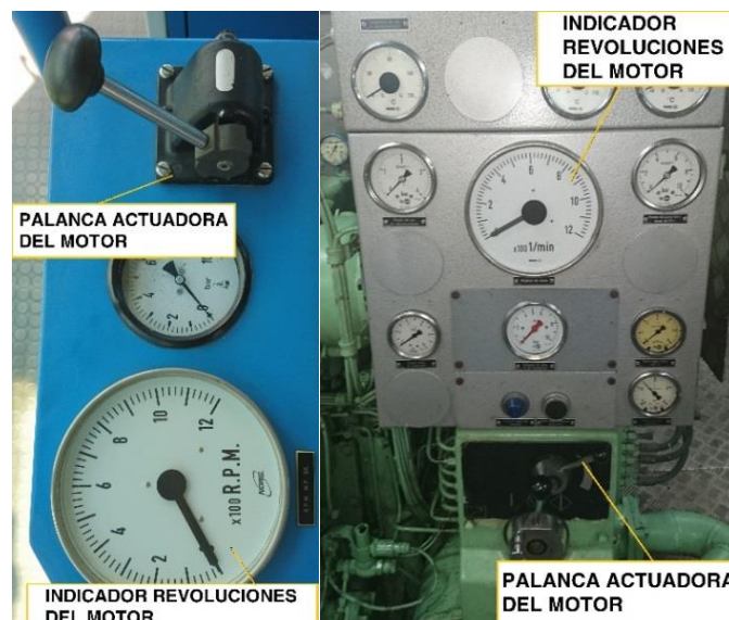
Figura 59. Controladores de los motores principales (Puente y Sala de máquinas). Fuente: Elaboración propia.
