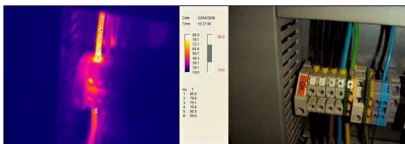
Figura 61. Termografía de cuadro eléctrico. Fuente [21]
