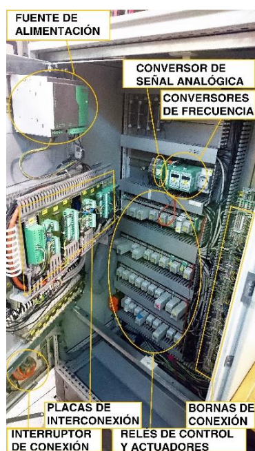
Figura 37. Cuadro eléctrico del propulsor. Fuente: Trabajo de campo.
