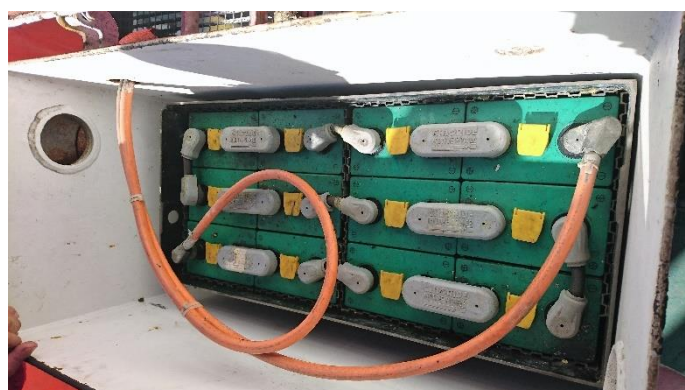
Figura 38. Cajón de baterías de emergencia. Fuente: Trabajo de campo.
