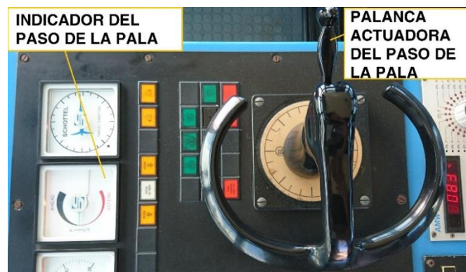
Figura 56. Controles para el paso variable del puente. Fuente: Elaboración propia.
