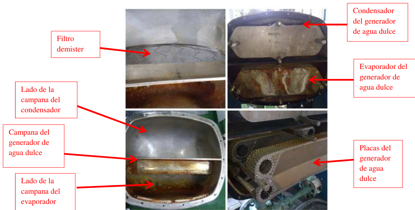
Ilustración N°43. Campana del generador de agua dulce
