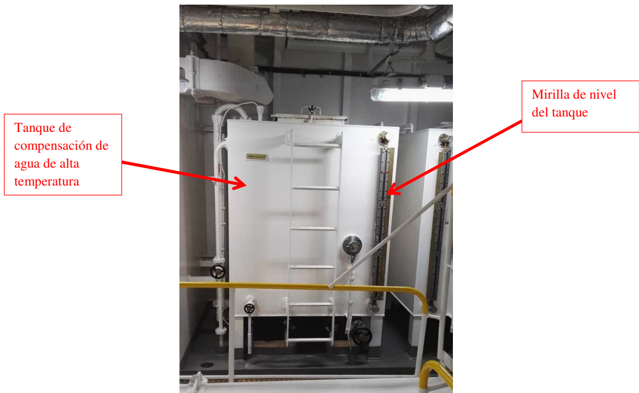
Ilustración N°39. Tanque de compensación de agua de alta temperatura
