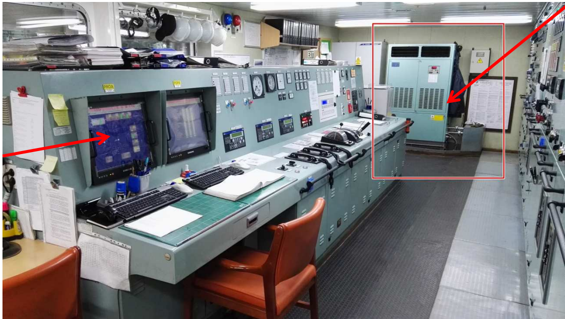
Ilustración N°37. Sala de control y ubicación del equipo de aire acondicionado
