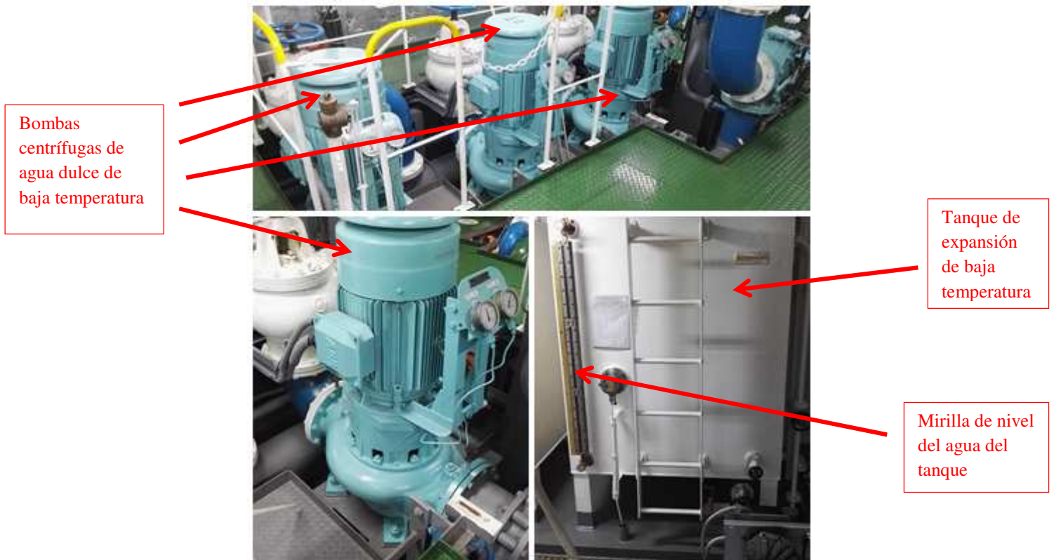
Ilustración N°34. Bombas centrífugas de agua de baja temperatura y el tanque de expansión de agua de baja
