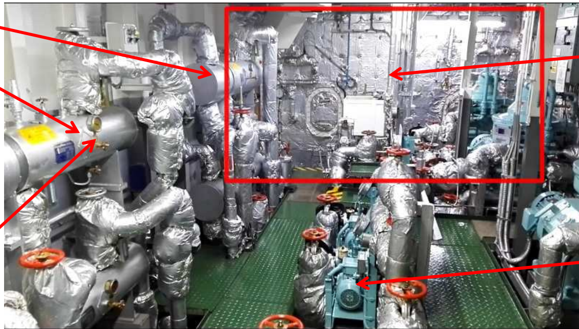
Ilustración N°52. Módulo de combustible con los tanques de diario de fuel al fondo
