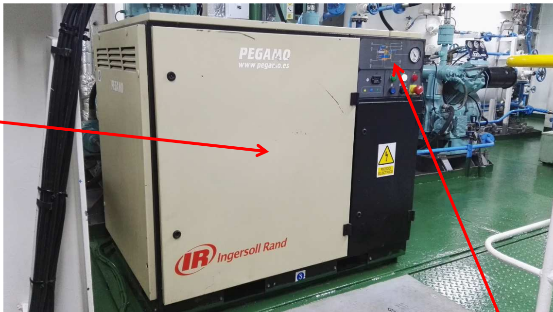
Ilustración N°50. Compresor de aire de cubierta
