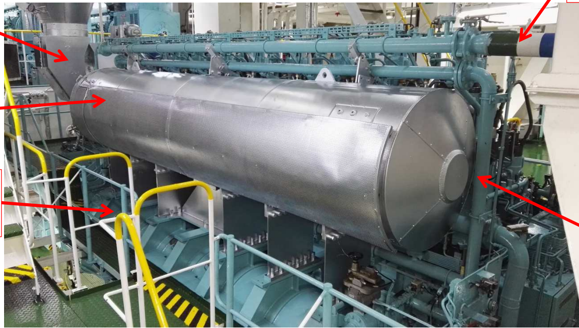
Ilustración N°42. Motor propulsor desde la banda de estribor
