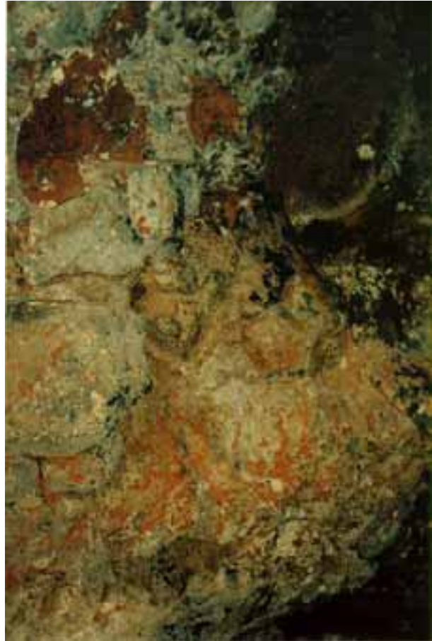
fig. III.110 C. DE LA CANDELARIA Aspecto que presenta un trozo de la viga de piedra divisora del techo, la cual marca el comienzo de la dependencia derecha.
