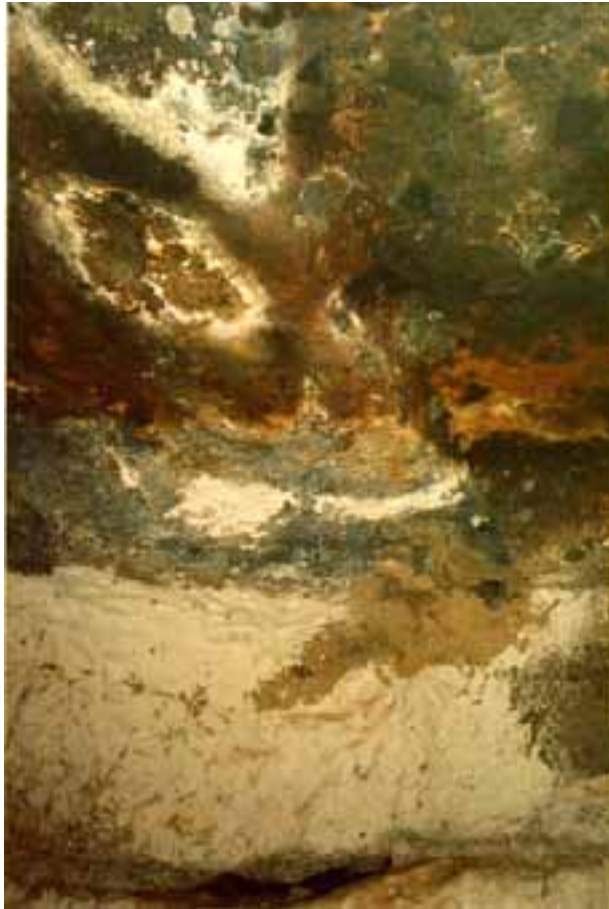
fig. III311 MESA DE LA PUNTA C 14 Aspecto que presenta el techo de la cueva en la zona central.
